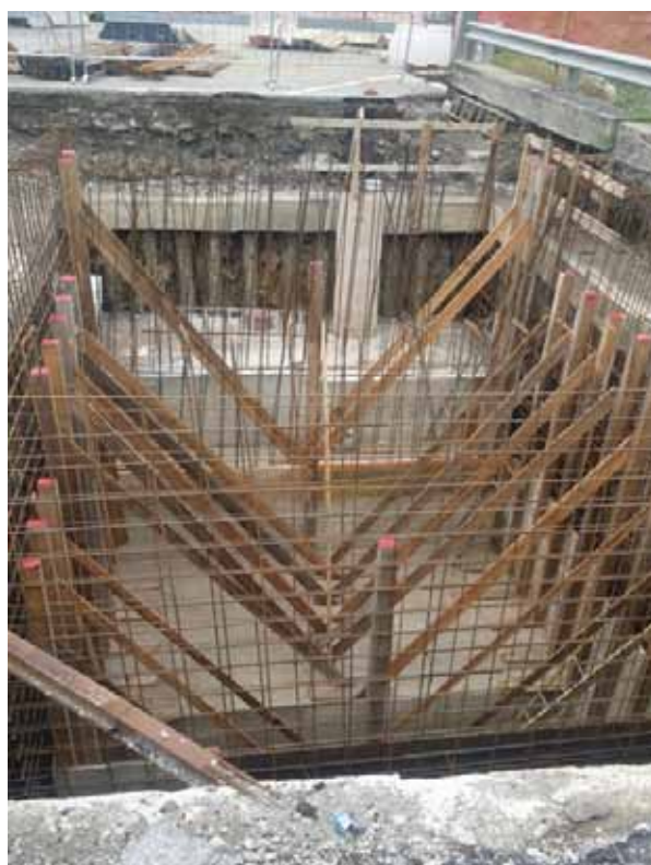
Fig. 9 – Particolare della vasca di sollevamento principale.
