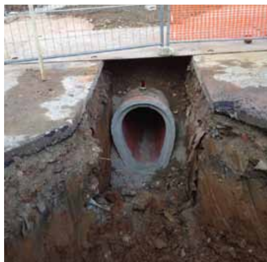
Foto 2: Osio Sopra Tubazione by-pass centro storico
