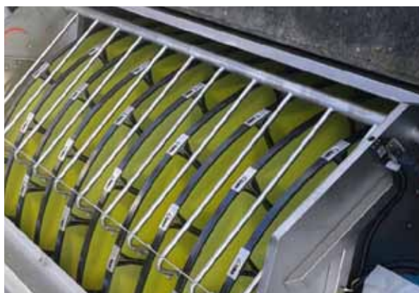
Foto 2: filtro a disco installato
