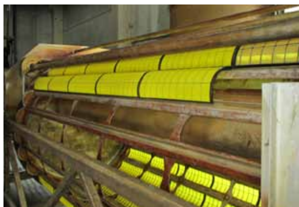
Foto 1: filtro a tamburo rimosso
