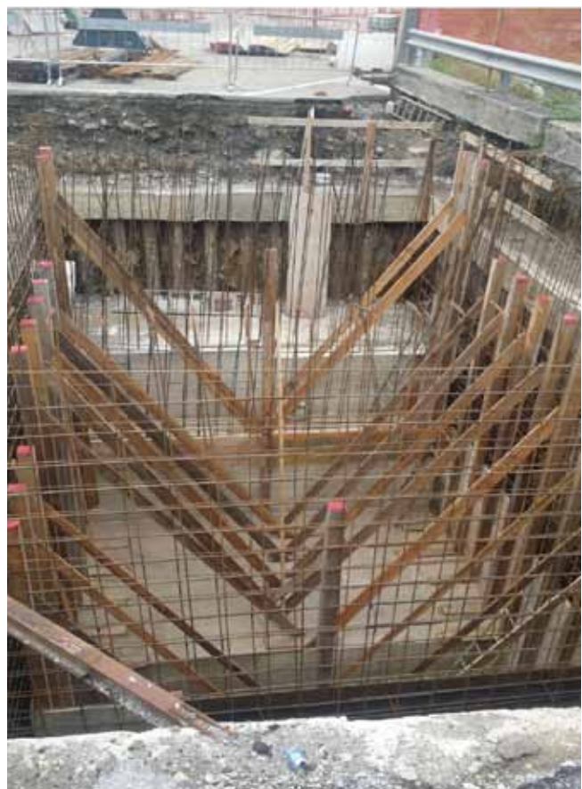
Foto 2: particolare vasca di sollevamento principale
