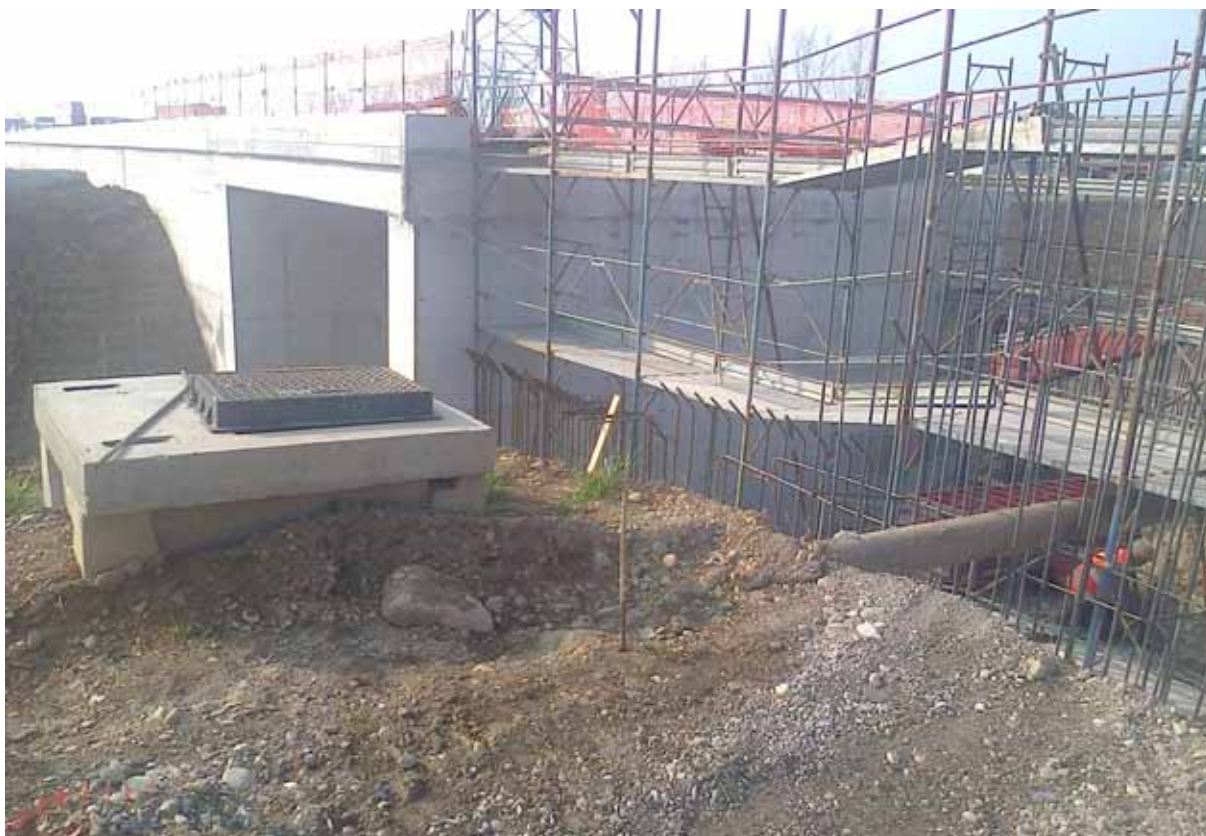
Foto 3: Attraversamento dell'impalcato stradale con condotta idrica
