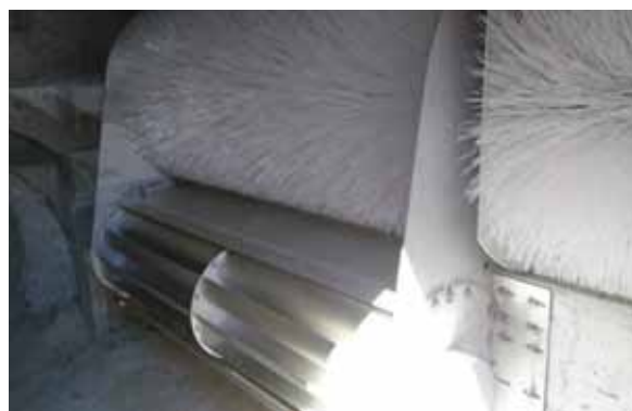
Foto 2: sistema di grigliatura delle acque sfiorate installato nel manufatto sfioratore
