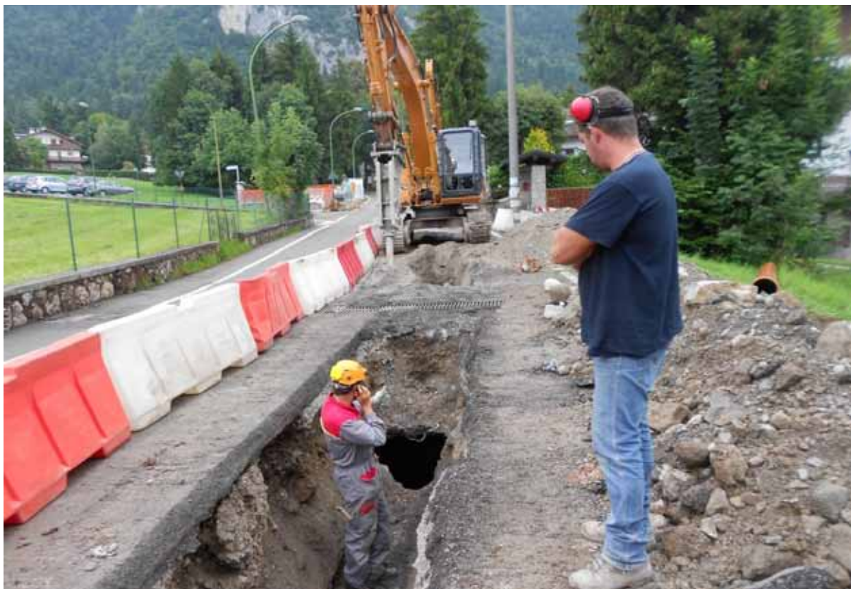
Foto 1: Ritrovamento cavità lungo via Monte Pora
