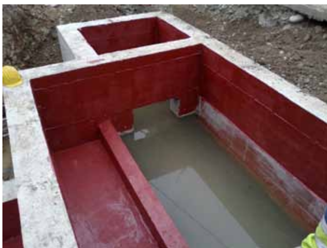
Foto 1: Osio Sotto Manufatto sfioratore in via Einaudi
