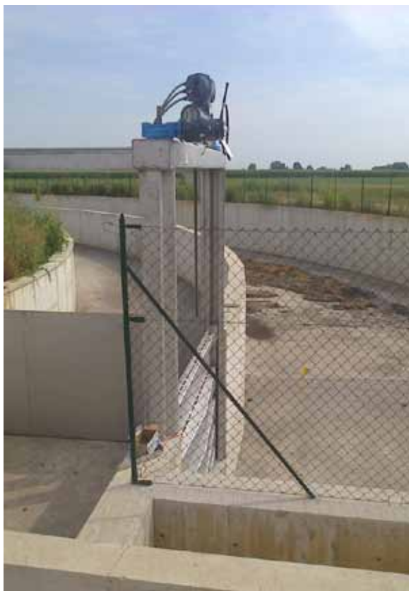
Foto 1: Nuova paratoia motorizzata
