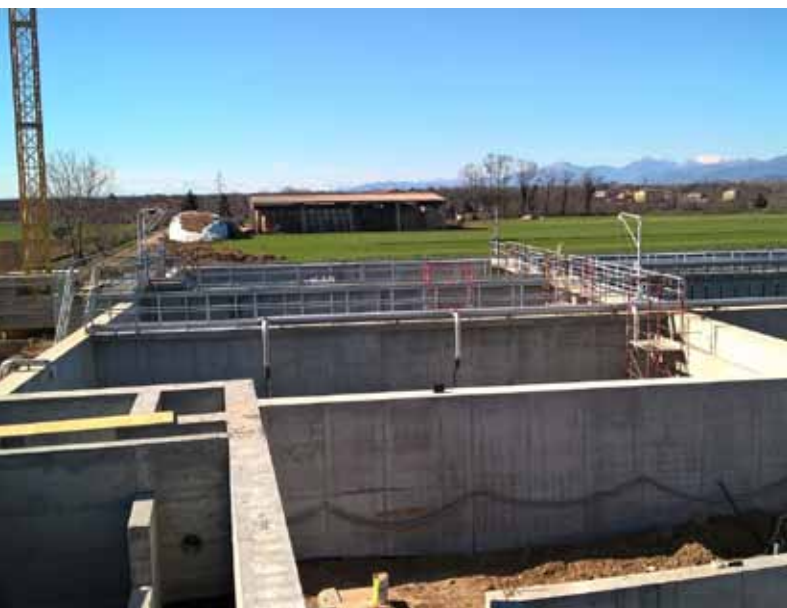
NUOVE SEZIONI DI NITRIFICAZIONE-DENITRIFICAZIONE
