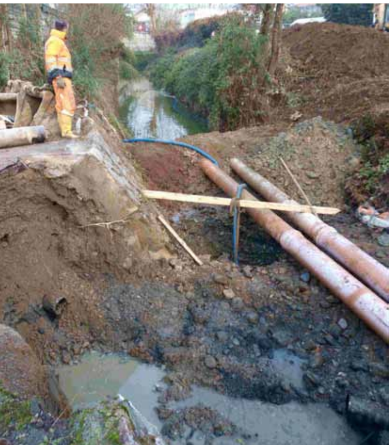
RECAPITO DELLE ACQUE FOGNARIE PRIMA DELL'INTERVENTO
