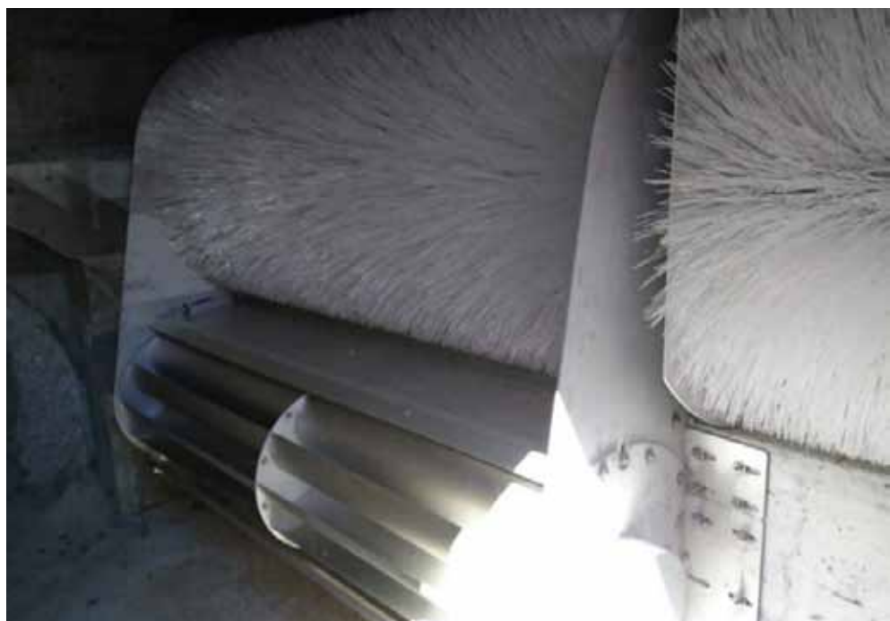
SISTEMA DI GRIGLIATURA DELLE ACQUE SFIORATE INSTALLATO NEL MANUFATTO SFIORATORE
