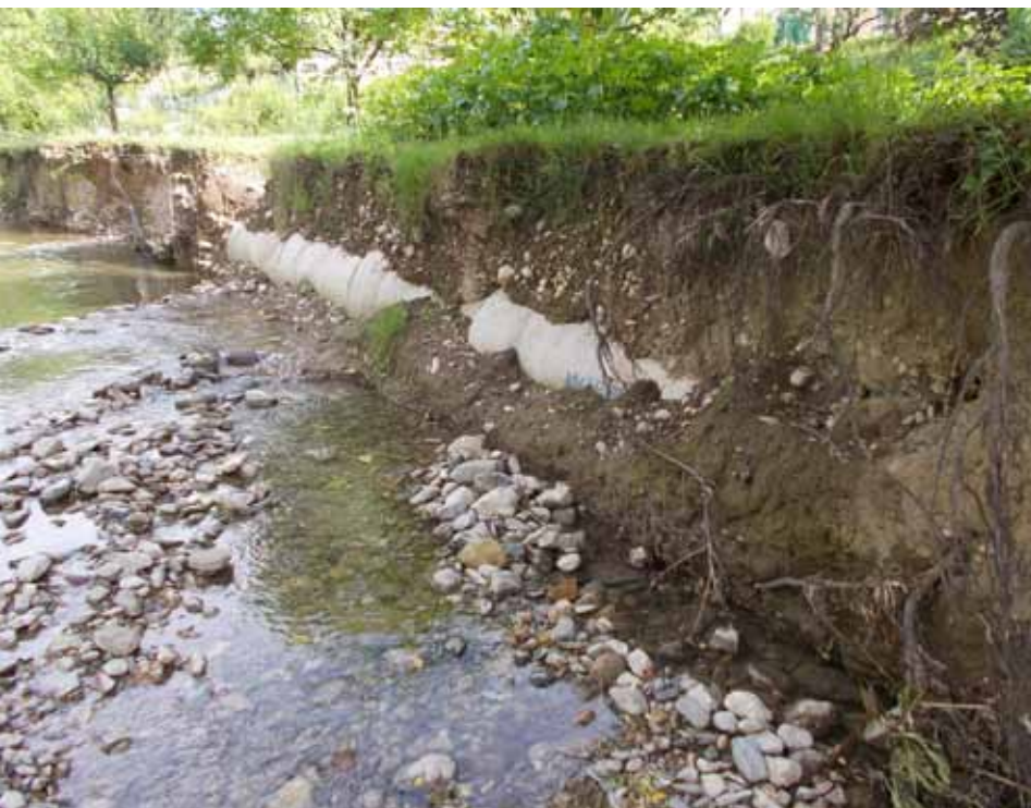
EROSIONE SPONDA DEL TORRENTE FINO A SCOPRIRE IL COLLETTORE FOGNARIO
