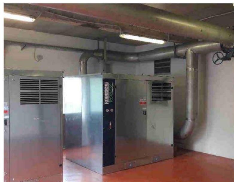
NUOVE SOFFIANTI A SERVIZIO DELL'OSSIDAZIONE E RELATIVO PIPING
