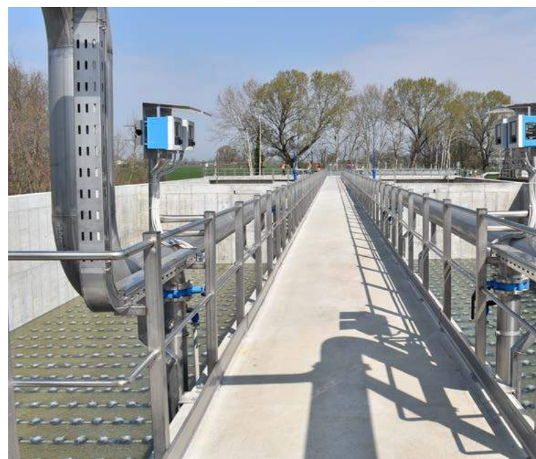
NUOVO COMPARTO BIOLOGICO COMPLETO DELLE INSTALLAZIONI ELETTROMECCANICHE
